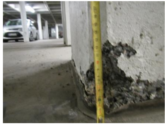
Kuva 5. Betonia on irronnut noin 150 mm:n korkeudelle lattiapinnasta
