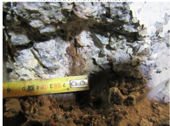
Kuva 7. Raudoituksessa on syöpymiä.
