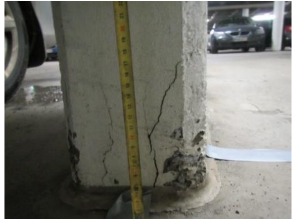
Kuva 9. Juurella on teräskorroosion aiheuttamat halkeamat noin 200 mm:n korkeudelle.
