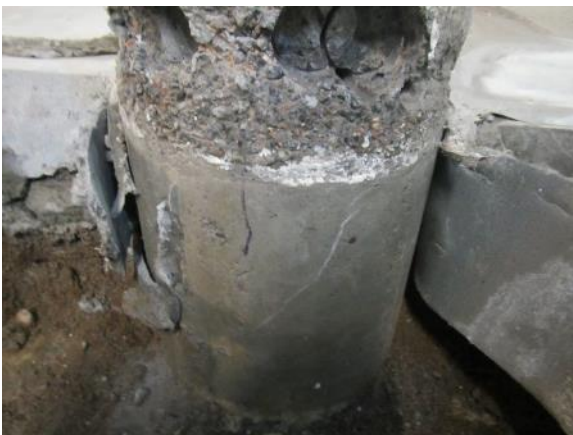
Kuva 24. Näytteenottokohdat rapautumasta ja hyväkuntoinen betonipinta alempana.
