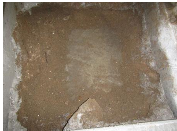
Kuva 13. Anturan yläpinta on paljastetulta osin hyväkuntoinen. Anturasta otettiin 2 näytettä.
