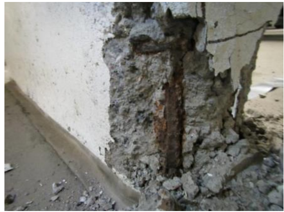
Kuva 11. Raudoitus on kohdassa syöpynyttä.
