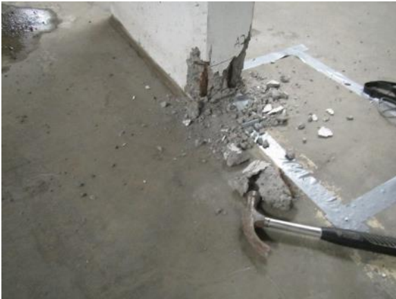
Kuva 10. Rapautumisvaurio on lattiapinnan yläpuolella.
