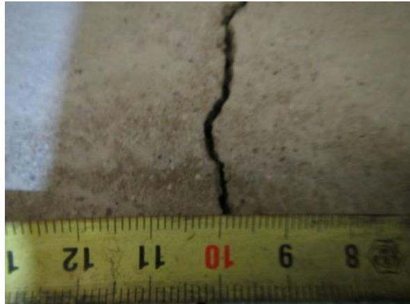
Kuva 27. Halkeamat ovat erittäin leveitä (>1 mm).
